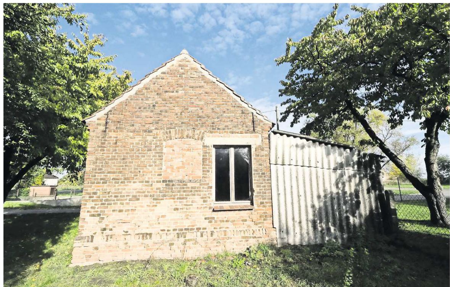
Das historische Backhaus in Nonnendorf soll mithilfe von Fördermitteln aus dem europäischen Leader Programm saniert werden.
